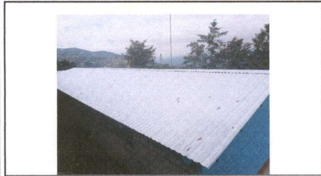
Foto1: Sustitución de lamina por lamina troquelada aluzinc calibre 26 del modulo 2 del establecimiento.
